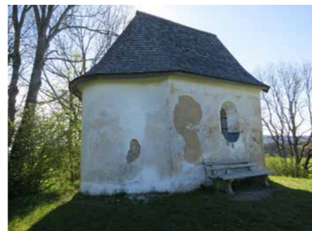
Abbildung 4: Die Frauenberg-Kapelle von Sufferloh in Oberbayern liegt exponiert auf einem Hügel im Voralpenland. Wenige Jahre nach einer umfassenden Sanierung tauchten erneut massive Schäden durch Feuchte an der Fassade und Algenwachstum im Innenraum auf, die dazu führten, dass die Kapelle nicht mehr genutzt werden konnte. © Fraunhofer IBP, 2017
