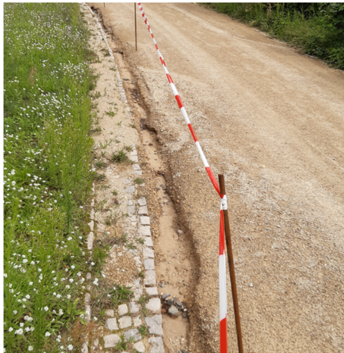
Abbildung 5: Durch Starkregen ausgespülte Wegekante im Park Babelsberg © SPSG, Anne-Grit Reichelt
